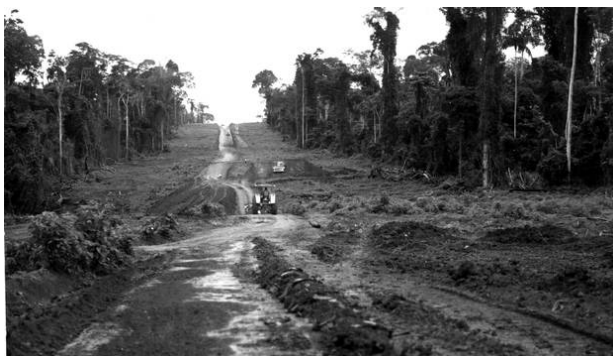
Fotografia 2: Ruínas do progresso 35 .
